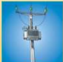
Transformateur moyenne tension/basse tension
