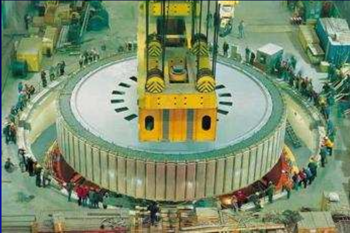
Turbine de l'une des 26 centrales hydroélectriques
